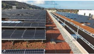
Postulat Frei: • Finanzieller Anreiz für grosse Anlagen ohne Eigenverbrauch • Solarstromanteil im Standardstrommix
